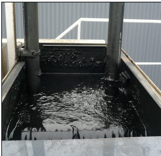
Figura 2. Muestra el aspecto de la mezcla de recirculación con CAP que retorna al sistema para obtener la máxima eficiencia en la eliminación de los micro-contaminantes orgánicos y el mínimo consumo del CAP.
