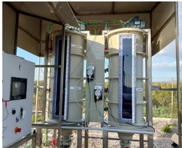
Figura 3. Planta piloto de cristalización de estruvita.
