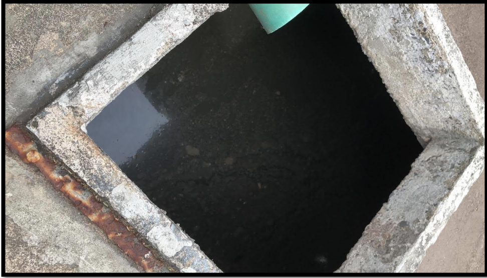
Figura 1. Tanque de Lodo Activado. Fuente Fotografía: Autor
