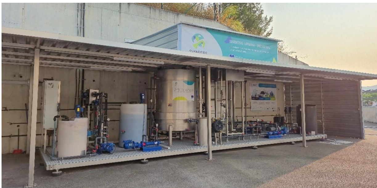
Figura 1. Planta piloto correspondiente al EcoSite español situado en la EDAR de Alcoy.
