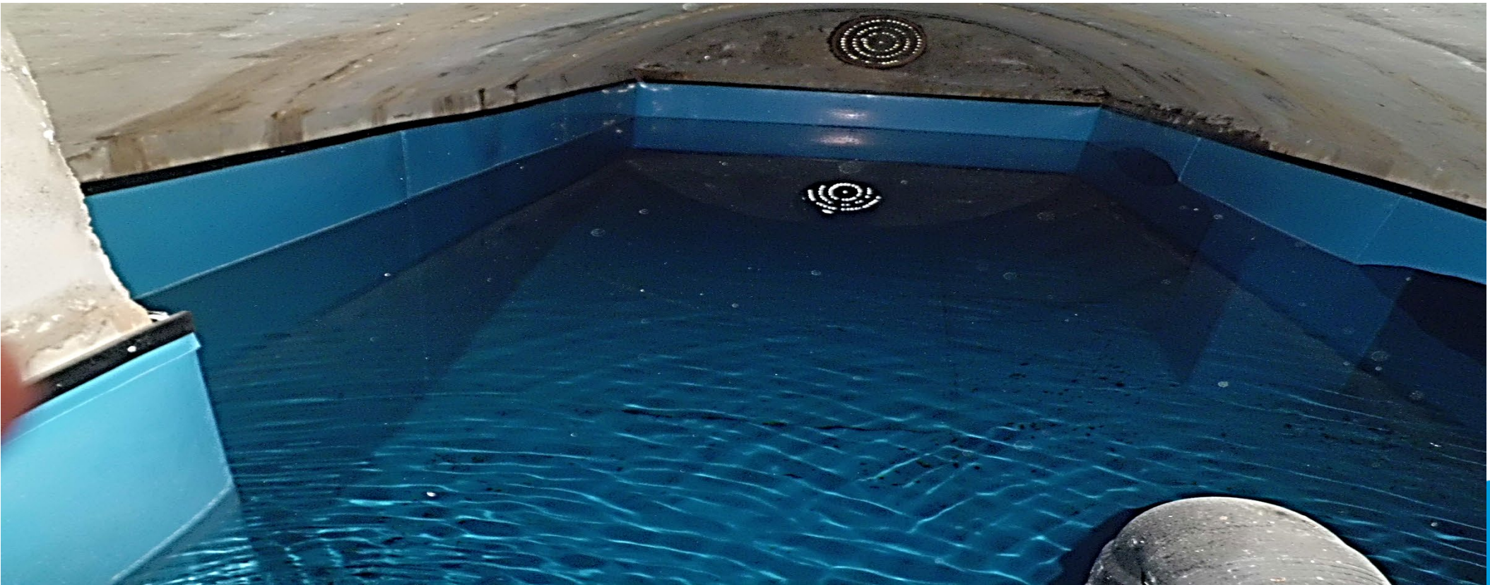
Deposito en funcionamiento
