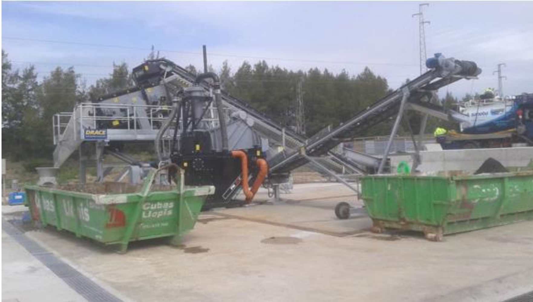
Instalación reciclado de arenas EDAR Copero, Sevilla 2014
