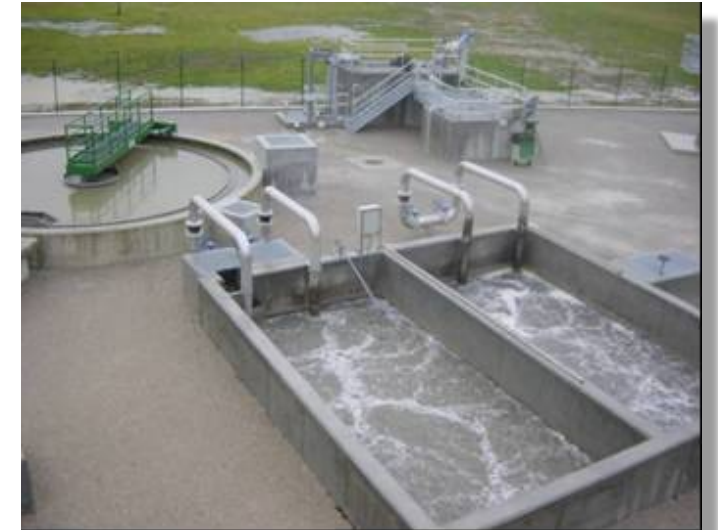
Reactores de Biomasa Fija sobre Lecho Móvil (MBBR)
