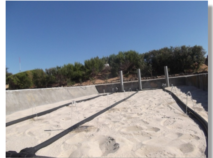
Filtros Intermitentes de Arena
