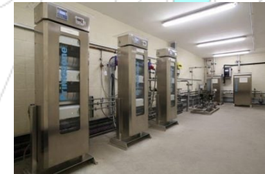
EQUIPO DE GENERACION DE OZONO
