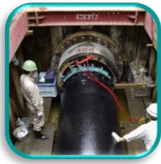
Tuberías de Hierro Ductil
