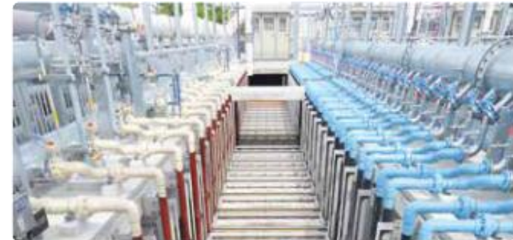
Sistemas de Tratamiento MBR
