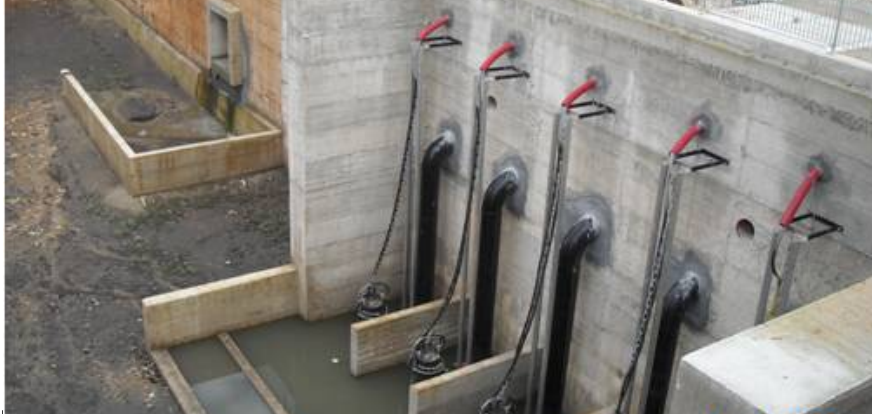
Recogida y bombeo de pluviales
