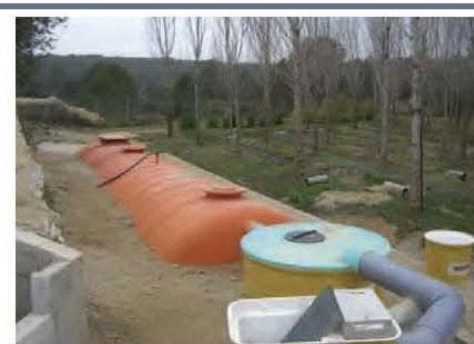
INSTALACIÓN DEPURADORA PERFIL HIDRÁULICO
