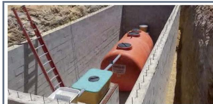
INSTALACIÓN DEPURADORA PERFIL HIDRÁULICO
