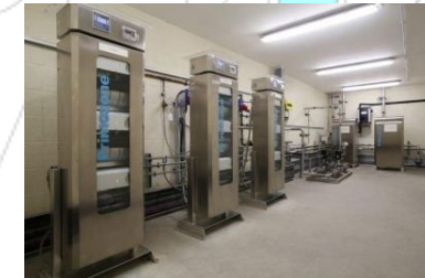
EQUIPO DE GENERACION DE OZONO
