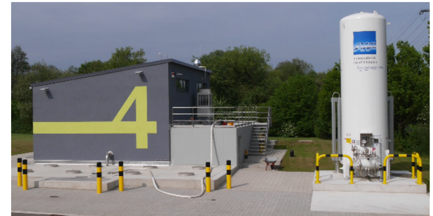
Edificio operativo (izquierda) incl. depósitos de reacción, unidades de filtrado (centro) y suministro de oxígeno (derecha)
