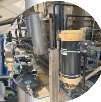
Recuperación de CH 4
