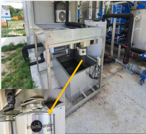
Unidad de tratamiento de la FORSU
