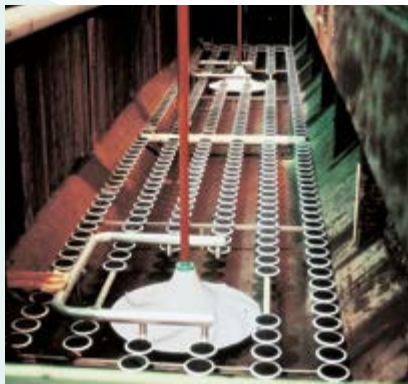
2 agitadores HYPERCLASSIC® en una planta de tratamiento de aguas residuales en Stockholm, Suecia
