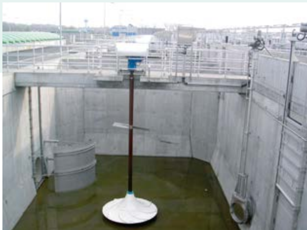
1 agitador HYPERCLASSIC® de un total de 32 en una planta de tratamiento de aguas residuales en Viena, Austria
