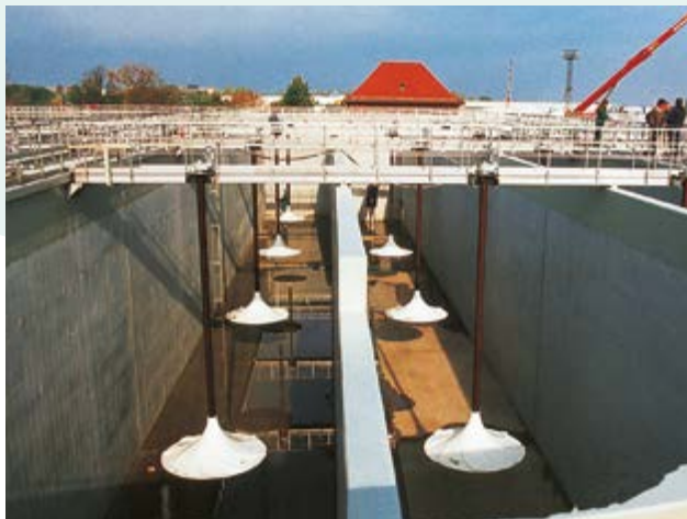
7 agitadores HYPERCLASSIC® de un total de 33 en una planta de tratamiento de aguas residuales en Berlín-Stabnsdorf, Alemania
