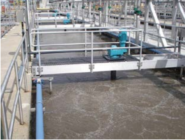
3 agitadores HYPERCLASSIC® de un total de 90 en una planta de tratamiento de aguas residuales en Bowery Bay, New York, EE.UU.
