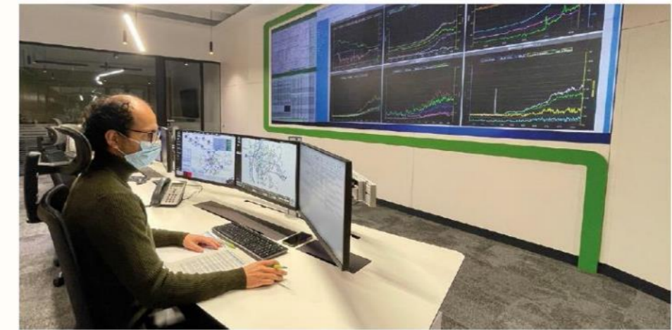
Centro de Control de Operaciones. Punto neurálgico de EMASESA para la continuidad y calidad del servicio.
