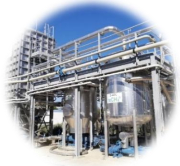
EDAR Copero I (comercial)
