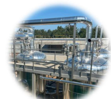
EDAR Copero II (comercial)
