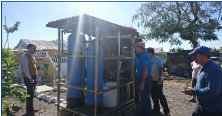
PLANTA POTABILIZADORA PINAR DE RÍO (Cuba)
