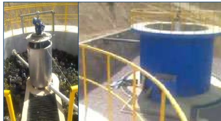
E.D.A.R CAPITAL COLQUÉPATA, CUSCO, PERÚ) 85 m3 SYSTEM-P Y BRAZOS DISTRIBUIDORES
